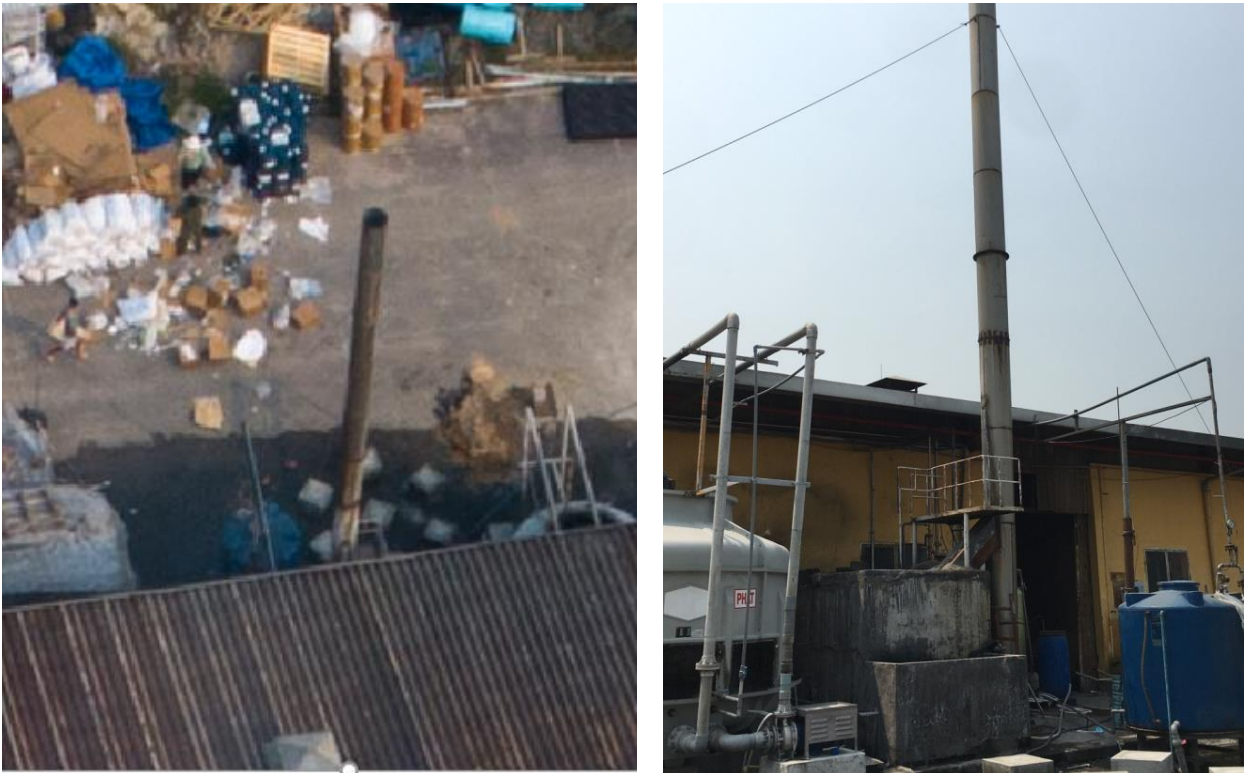
Hình 19. Lò hơi 2 tấn/h đang hoạt động tại cơ sở
